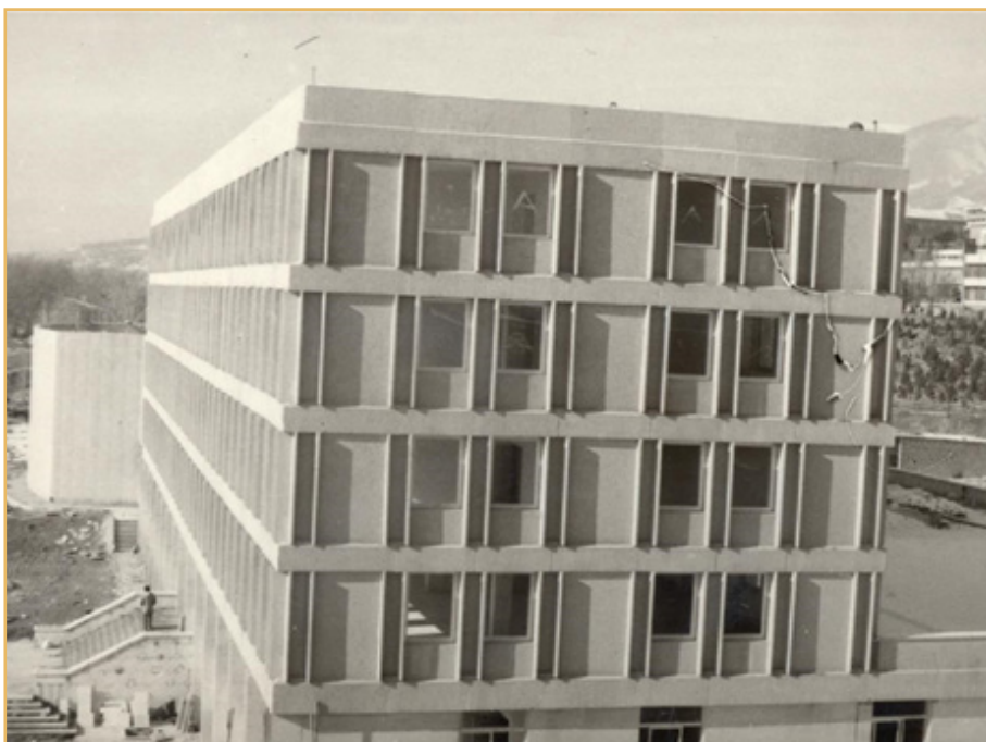
پیوست ۳- ساختمان در دست احداث سازمان تحقیقات کشاورزی و منابع طبیعی از نمای شرقی
