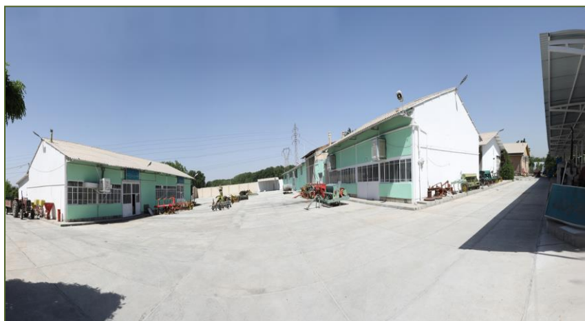
بازسازی (بتون ریزی کف محوطه و رنگ آمیزی) محوطه کارگاه های گروه فنی و ماشین‌های کشاورزی ۱۴۰۲
