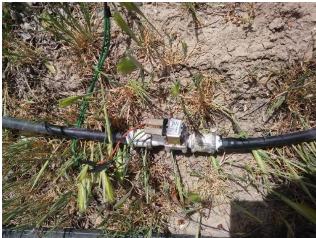
شکل ۳-۲۳: عملگر شیر برقی سامانه آبیاری قطره ای
