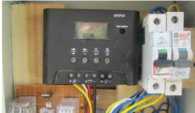
شکل ۴-۲: شارژ کنترلر نصب شده در سیستم فتوولتائیک.
