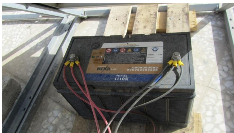
شکل ۴-۴: باطری نصب شده در سیستم فتوولتائیک
